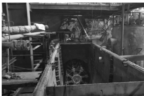
Рис. 1. Расположение перемешивающего устройства в корпусе аппарата на месте эксплуатации
