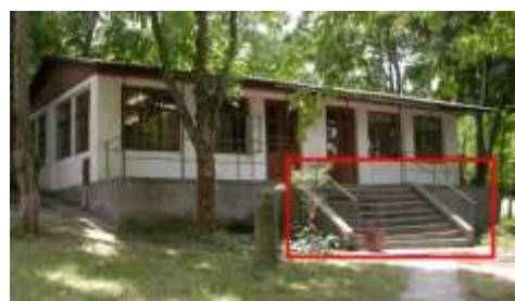
Рис. 8. Деформации верхнего камерального павильона. Фото 2005 г.
