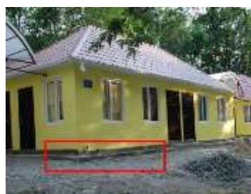
Рис. 7. Деформации домиков постройки 2009 года. Фото 2005 г.
