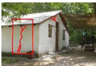
Рис. 6. Деформации домиков постройки 1975 года. Фото 2005 г.
